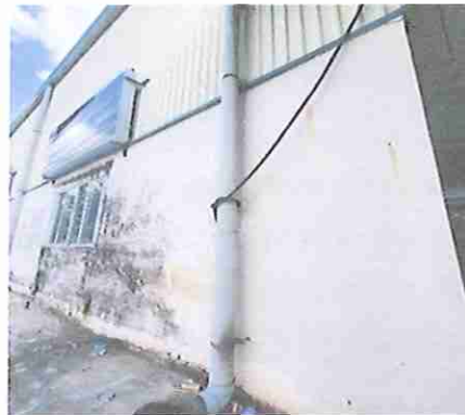
Hình 2. 3. Đường ống thu gom nước mưa từ trên mái nhà xưởng
