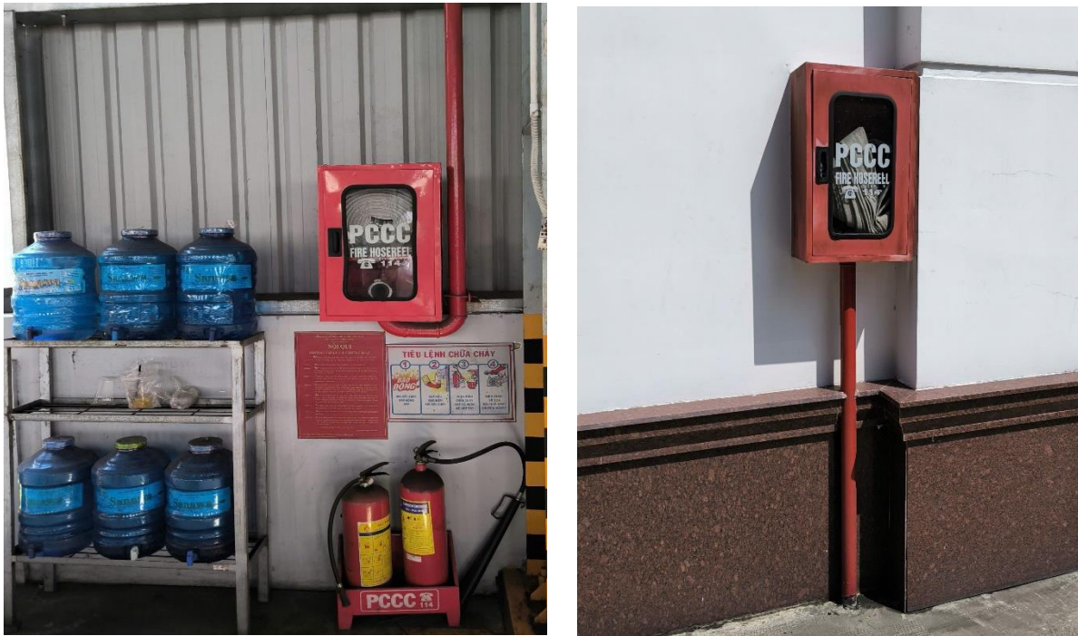
Hình 4.8. Một số thiết bị PCCC tại Công ty
